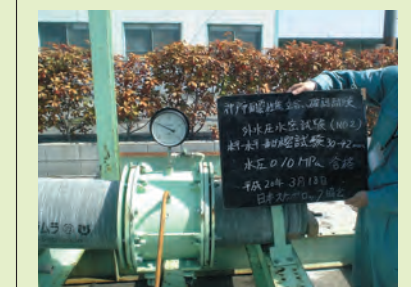
外水圧 0.10MPa×3分 漏水なし
