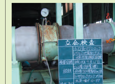
外水圧 0.10MPa×3分 漏水なし
